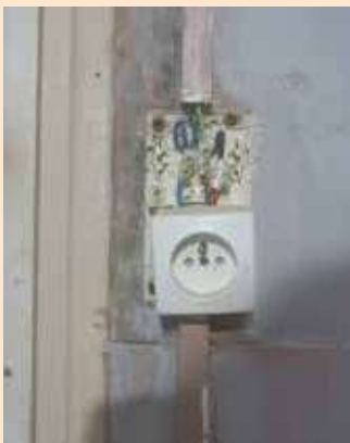
Installation électrique de la famille C.
